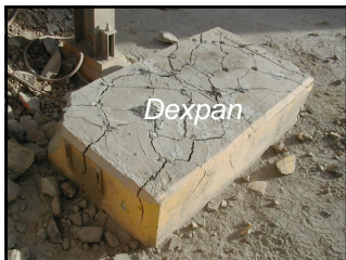
Base de 4' ancho X 7'3" largo X 2' grueso con varilla reforzada, se obtuvo un buen resultado con Dexpan.
